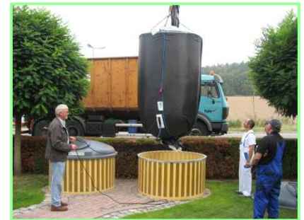
Leerung mit Kranhaken, Abstand zum Weg bis zu 8 Meter
