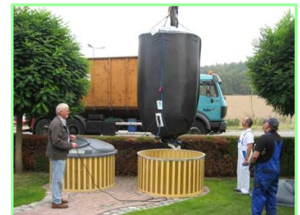
Leerung mit Kranhaken, Abstand zum Weg bis zu 8 Meter
